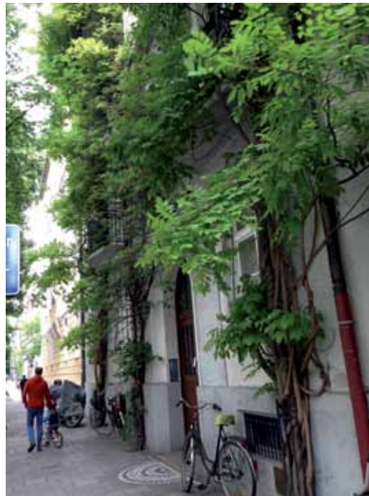
Wisteria sinensis (Chinesische Wisterie) schlingt bis in 10 m Höhe, braucht aber eine stabile Kletterhilfen. Regenfallrohre können durch sekundäres Dickenwachstum der starken Pflanze zerdrückt werden. Unbedingt alternative Schlinghilfen anbieten. (Foto: Prof. Dr. Duthweiler)
